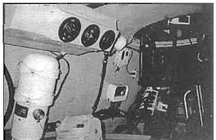
Foto 8. Evaporador sistema aire acondicionado.
