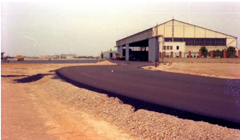
Obras de mejora en las instalaciones. (Imagen: Archivo fotográfico de la base aérea de Albacete)
