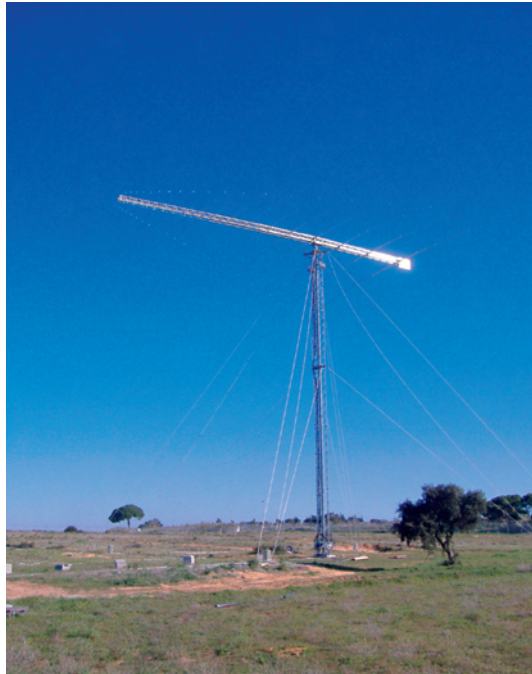
Antena de HF MAS-5 (cinco emisiones simultáneas de un kilovatio de potencia) con unos 40 m de altura.
