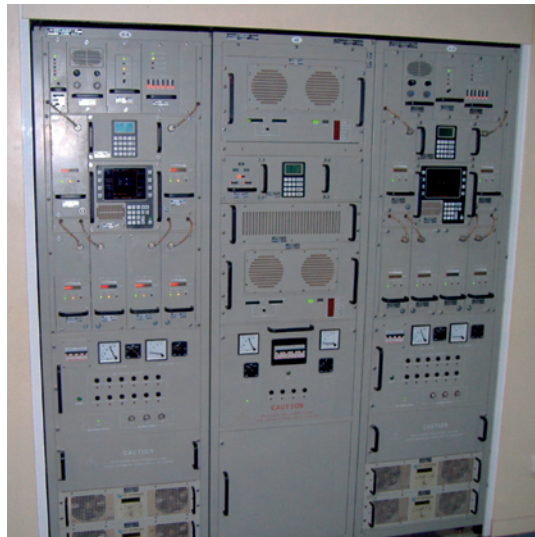
Equipo de 10 kW de potencia de estado sólido HF.
