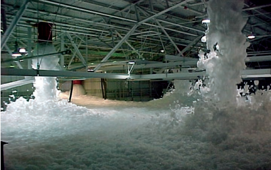
Inundación de un hangar con espuma de alta. (Foto: Viking «Aplicaciones de los Sistemas de Espuma»).
