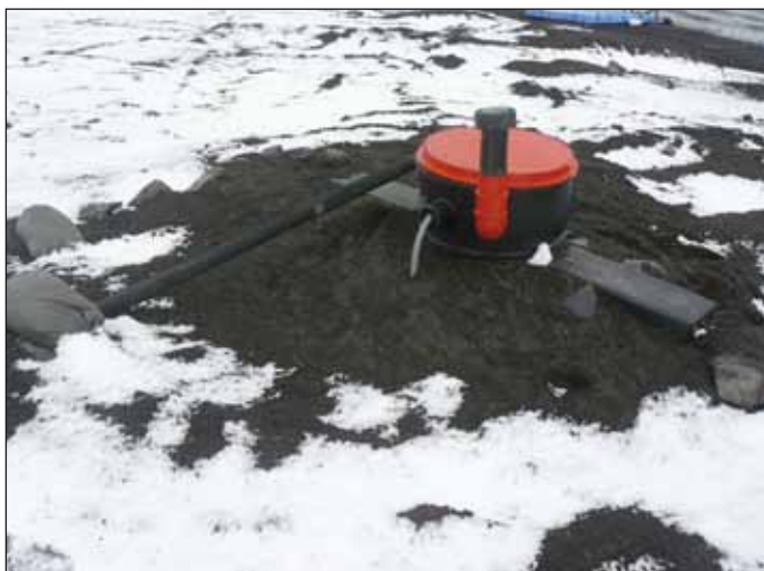
Figura 21. Reactor del sistema de depuración.
