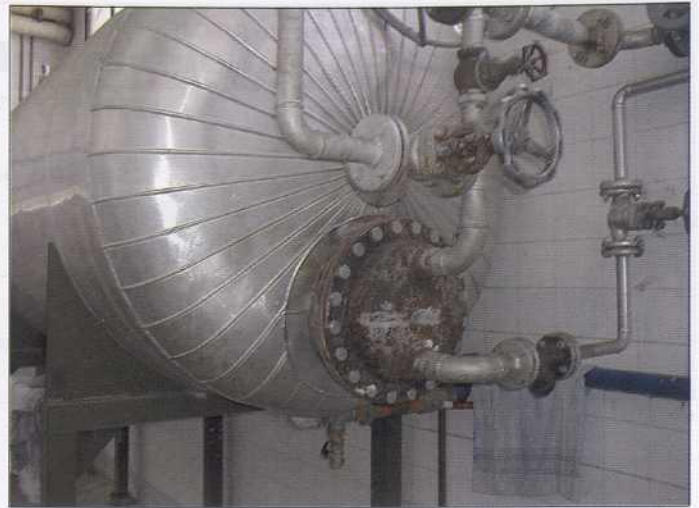
Fig. 7. Acumulador de agua caliente sanitaria.
