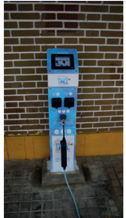
Punto de recarga de la electrolinera. (Imagen: CLOMA)
