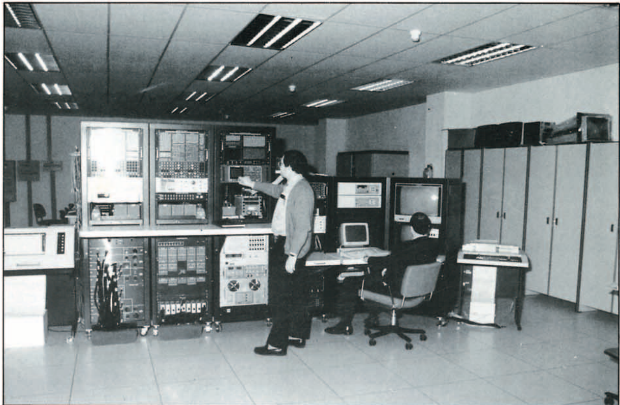
SMSSF. Banco de Apoyo al Sistema Gestor de Cargas.
