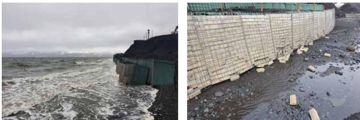
Efecto de la marea en el muro
