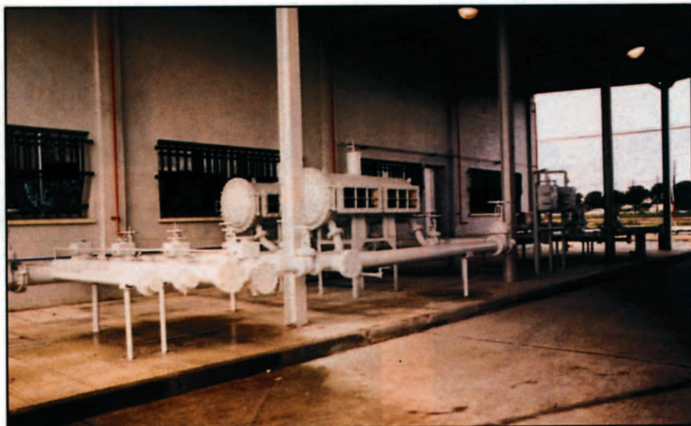
Instalación del Banco de Pruebas del Escuadrón Logístico de Combustibles.
