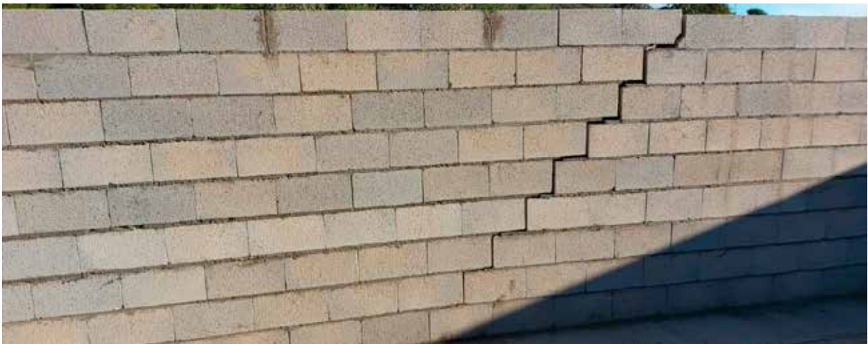
Figura 7. Muro en base a bloque de hormigón con grietas por hundimiento de losa
