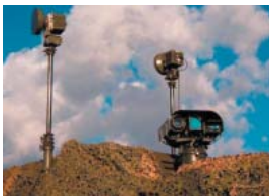
Detalles de las antenas del sistema de radioenlace (MINILINK) y de los sensores del sistema oprónico
