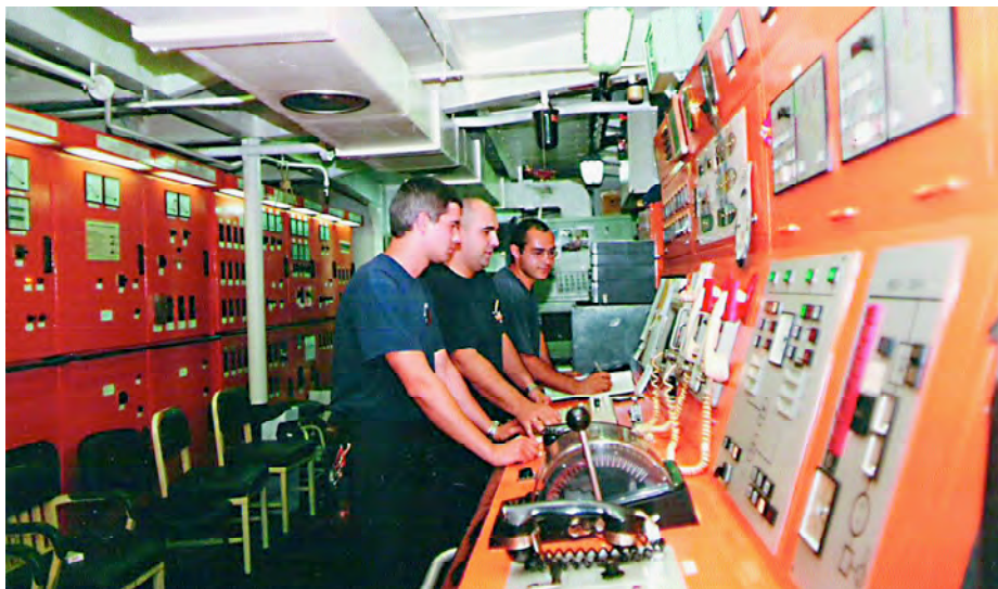
En la central de máquinas.
