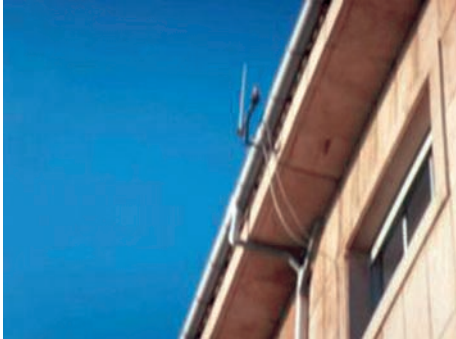
Fig. 5a.—Antenas AIS, GPS y VHF.
