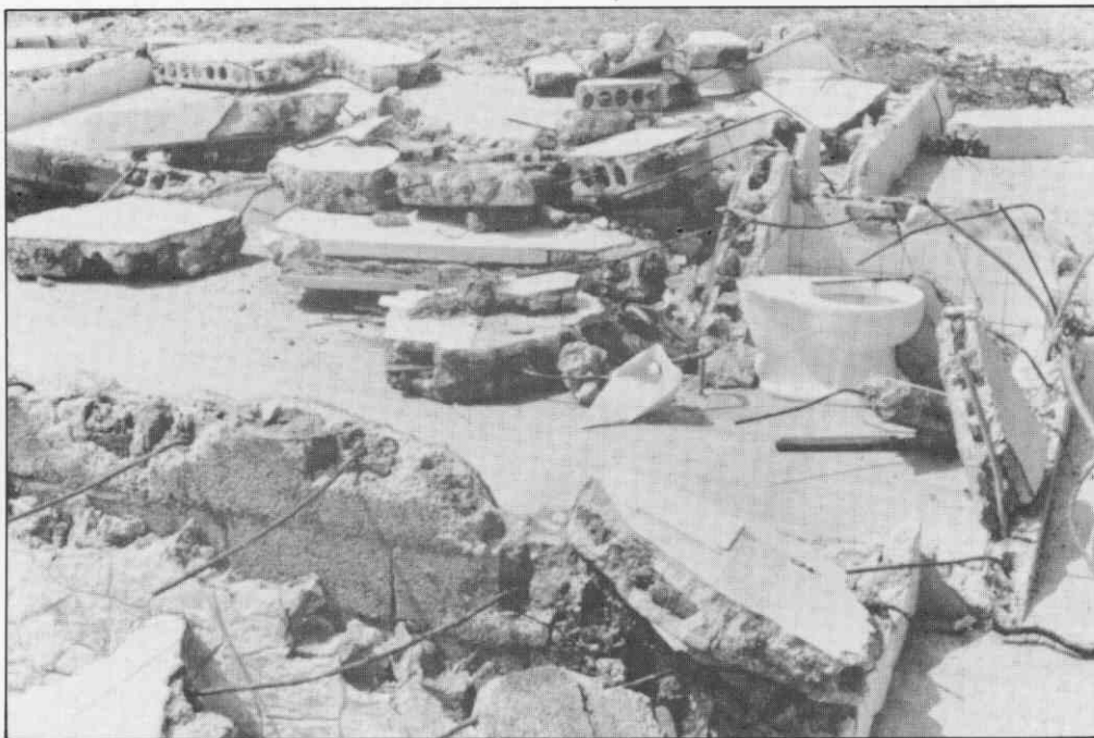
Dramáticos efectos producidos por las olas de la marea de temporal en las proximidades de Galina Point, en la costa Norte de Jamaica. Estos son los restos de un hotel situado en un acantilado de la costa.
