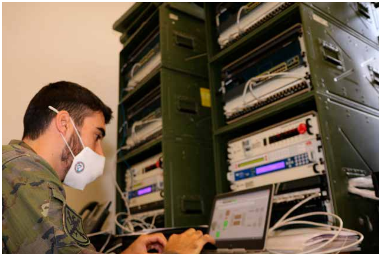
Ilustración 4: Configuración técnica de los equipos.
