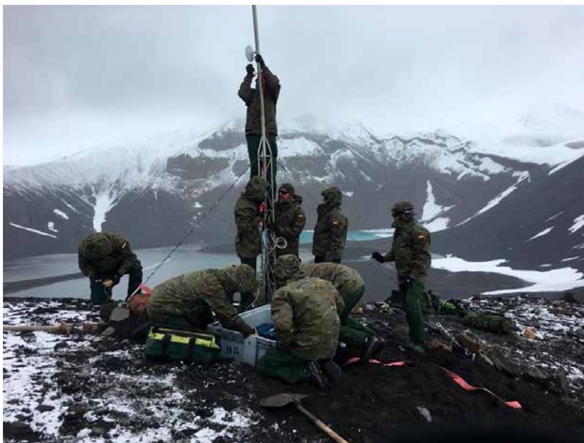
Ilustración 2: Instalación de repetidores VHF y radio-enlaces en Isla Decepción
