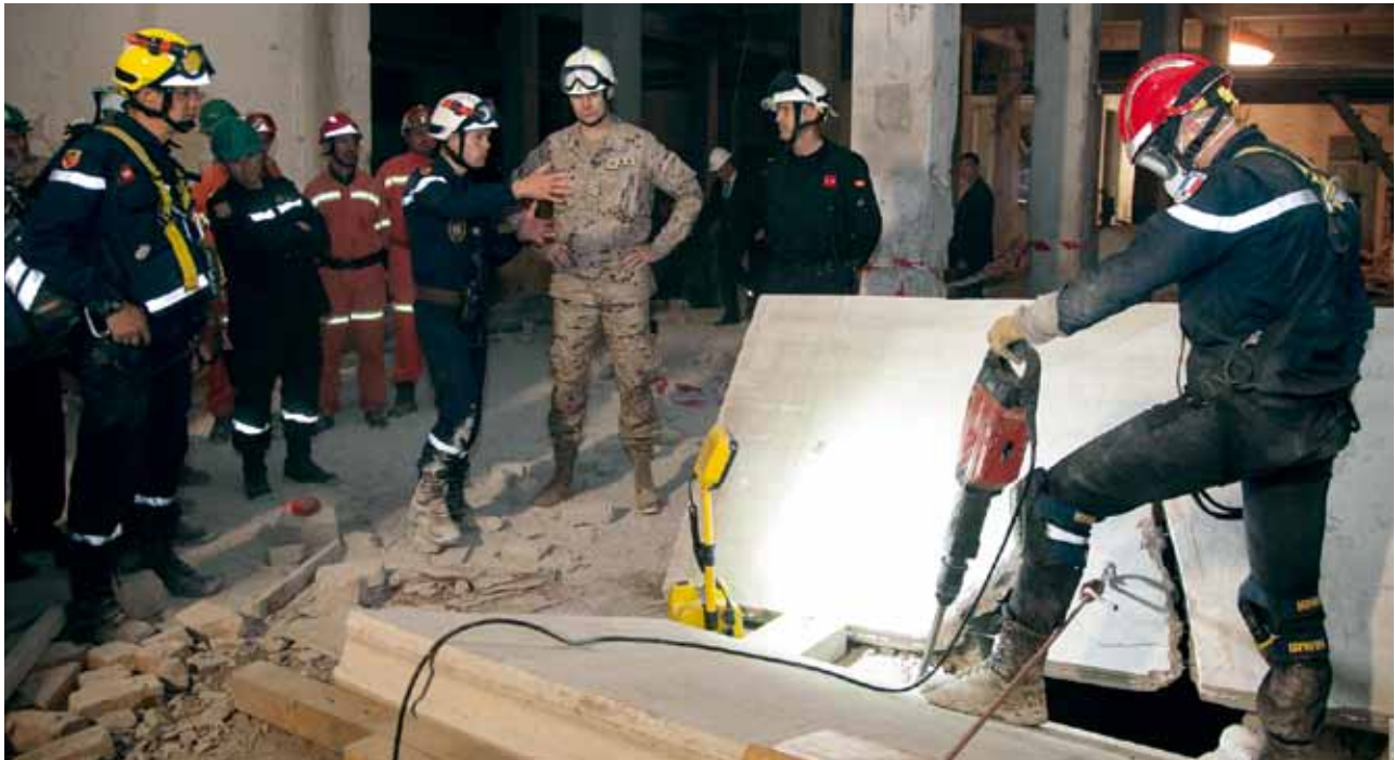
El Príncipe Felipe siguió los trabajos de apuntalamiento y rescate de víctimas provocadas por el derrumbe de edificios.
