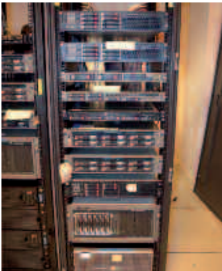
Rack de servidores del CGA.
