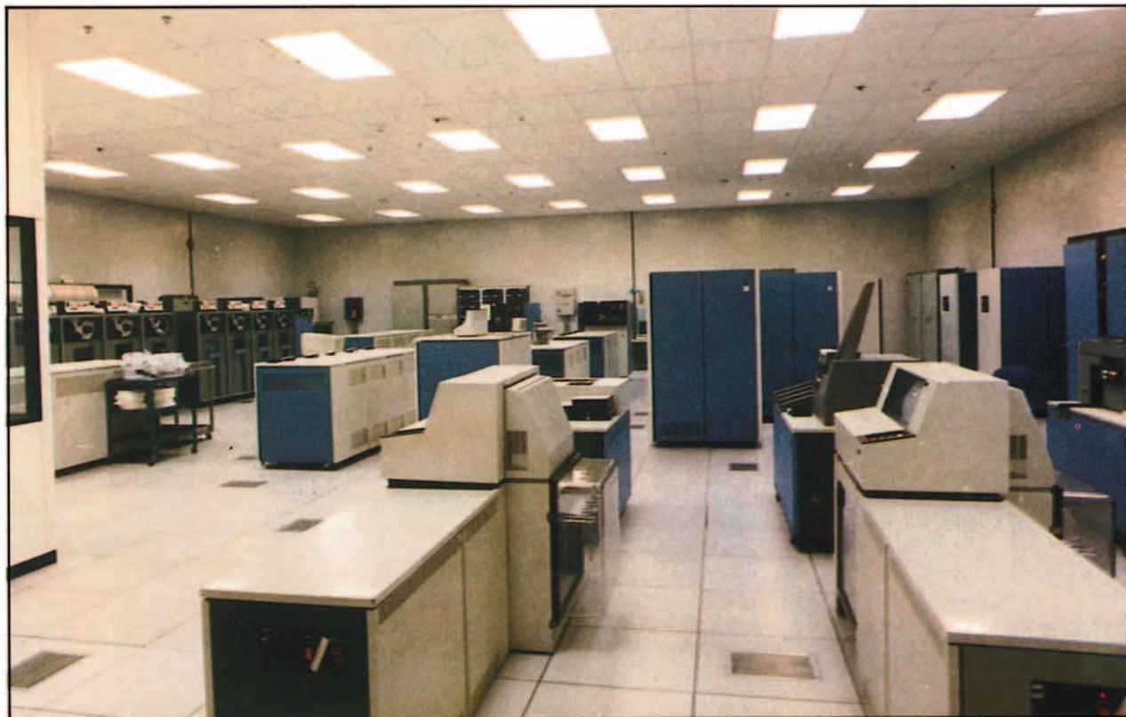
"Gran angular" de la Sala de Ordenadores del Centro de Proceso de Datos.
