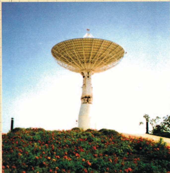
Antena de recepción del C.R.I.E. Maspalomas.
