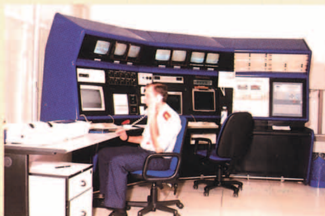
Control de Seguridad. El control de accesos y los sistemas de seguridad física del Centro se encuentran completamente informatizados.
