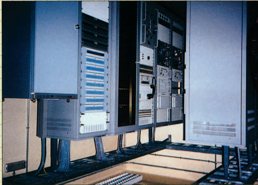
Equipamiento Radio T/A/T en estación desatendida.
