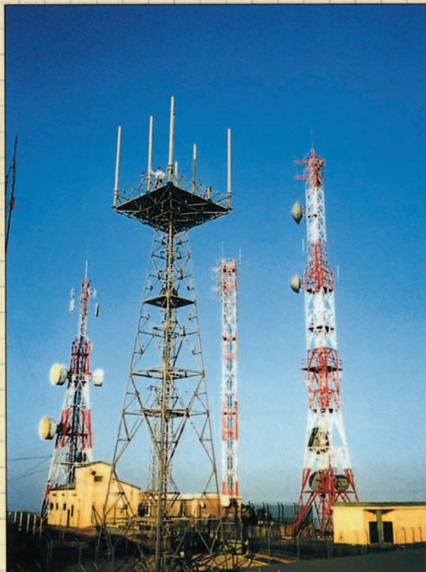
Torre con antenas de comunicaciones T/A/T.
