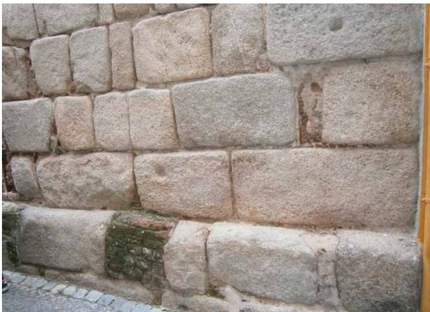
Restos del muro romano de Évora. Estas murallas, muy deterioradas por falta de mantenimiento, eran las que defendían la ciudad en el siglo X. Imagen del autor
