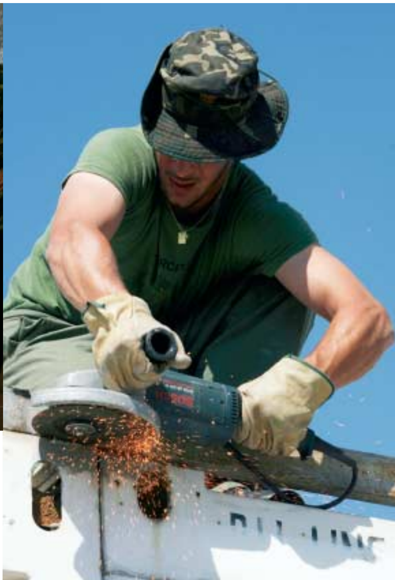
Un especialista de la Unidad de Repatriación desmonta, en la base de Mostar, la cubierta de los contenedores destinados a vivienda.
