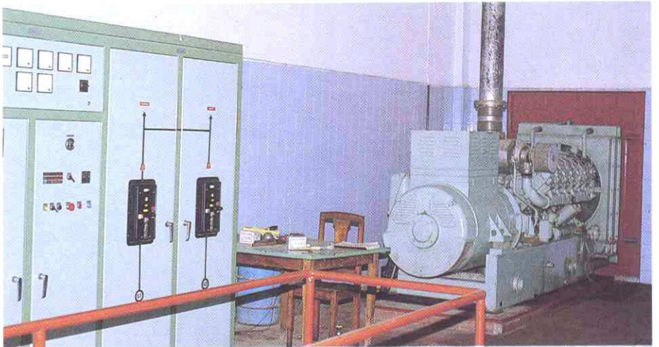
Grupos Electrógenos. Reserva de Electricidad.
