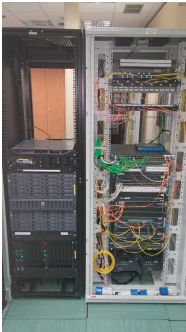
Equipamiento redundado en el segundo CPD
